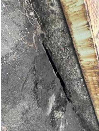
pH調整池の側面と地面との隙間
