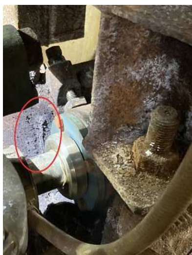
④赤丸箇所は飛び散ったグリス
