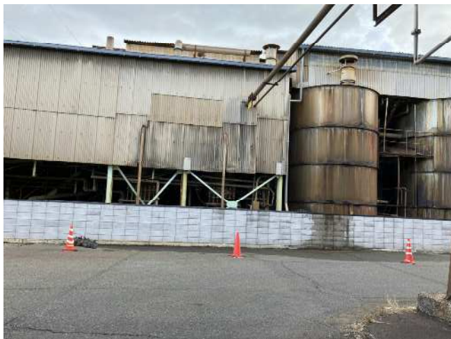
(1) 宇部ケミカル工場から見たAS工場 濡れているところが漏えい箇所
