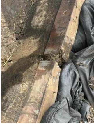
GD-3防液堤の亀裂
