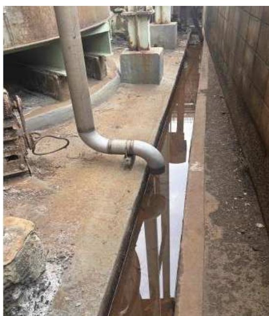
オーバーフローした排水は排水溝へ排出する。
