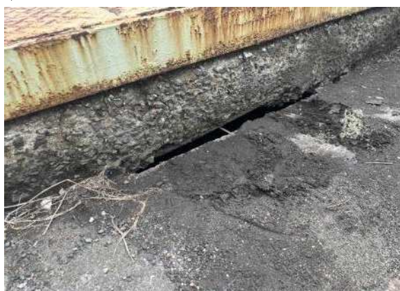
pH調整槽横の排水溝蓋とpH調整槽との間に排水が流れ込む隙間があった。（対策前）
