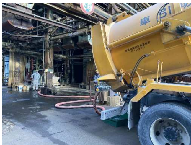
(5) 吸引した廃水はチタン工業の排水処理施設で適正 に処理
