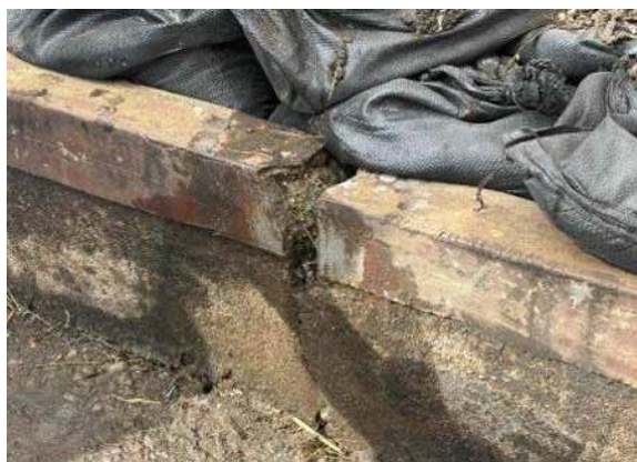
亀裂が生じた縁石（対策前）
