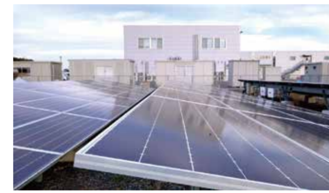
太陽光発電設備
