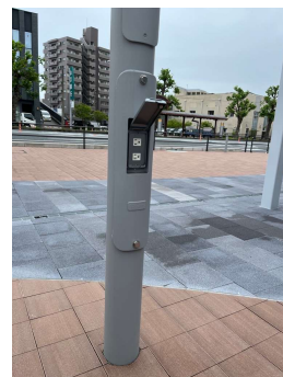
歩道照明コンセント(2口)
