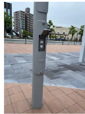
歩道照明コンセント(2口)
