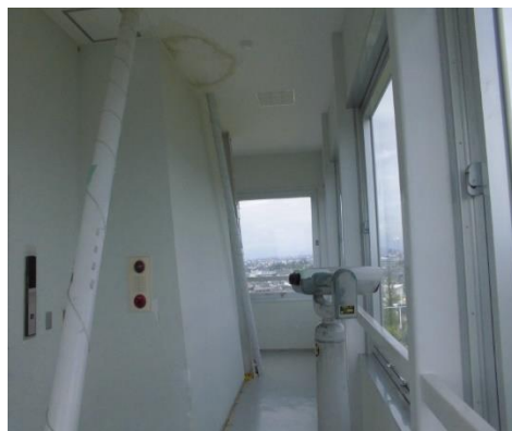
【展望室 天井】 漏水跡(シミ)
