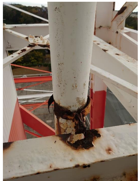
【鉄塔 クランプ】 腐食劣化
