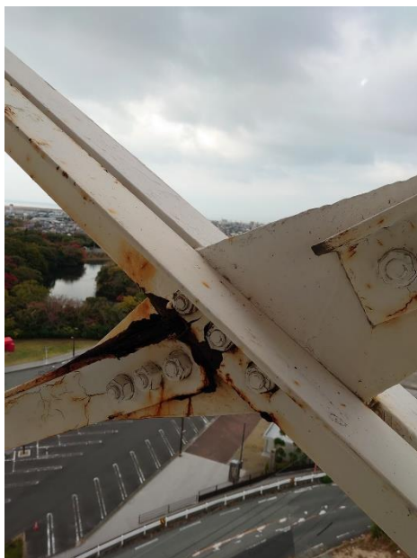
【鉄塔 鉄骨】 腐食劣化
