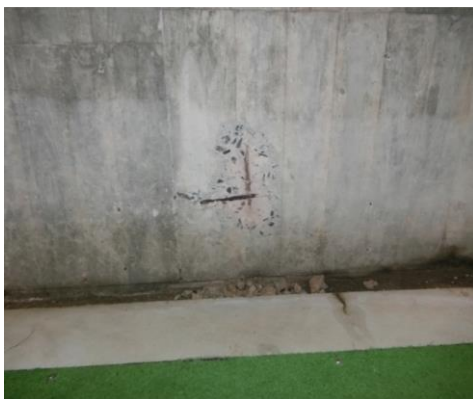
【1階 展示室 内壁③】 壁コンクリート一部爆裂、鉄筋発錆
