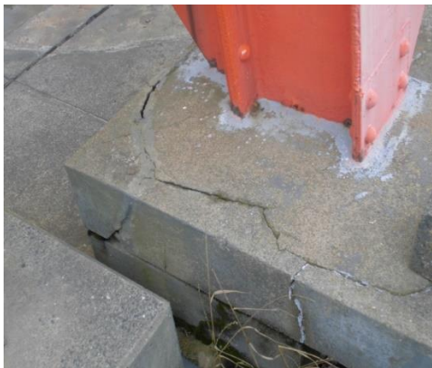
【鉄塔 架台】 コンクリート割れ
