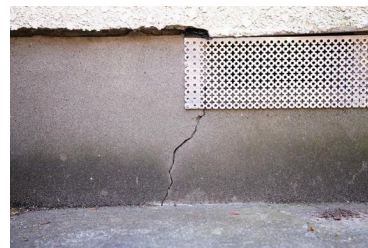
基礎のひび割れ
