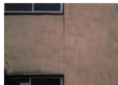
外壁の ひび割れ
