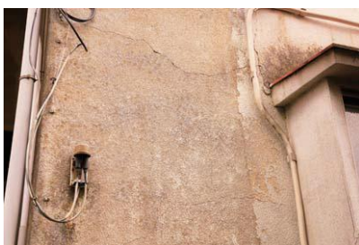
外壁のひび割れ ・コケ
