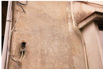
外壁のひび割れ・こけ
