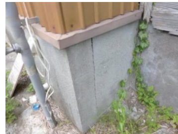
基礎の ひび割れ
