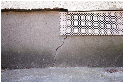
換気口付近の ひび割れ
