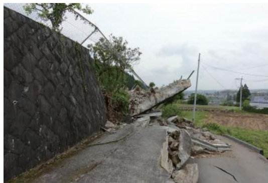
写真11 崩壊した擁壁
