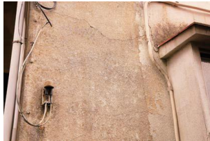
外壁のひび割れ・こけ
