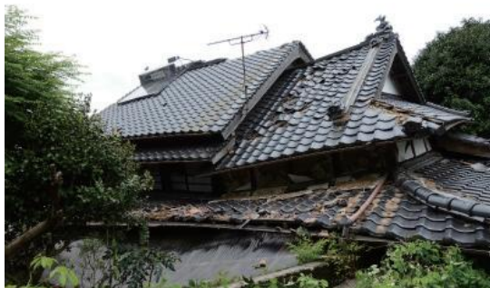
写真8 倒壊した木造住宅
