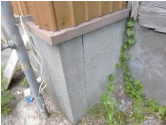
写真Ⅱ.2.2.6 基礎の割れ
