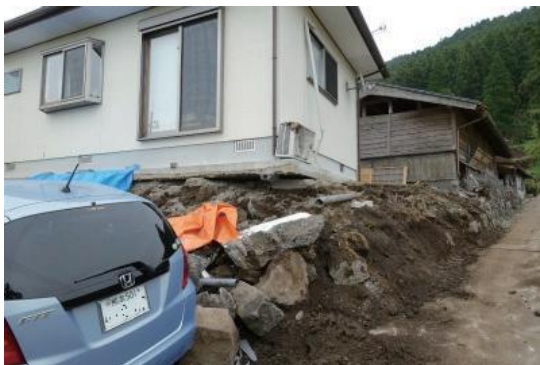
写真10 崩壊した擁壁
