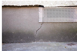
基礎のひび割れ
