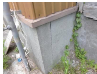
基礎の ひび割れ
