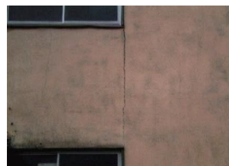
外壁の ひび割れ
