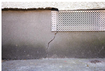
換気口付近の ひび割れ
