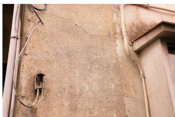
外壁のひび割れ ・コケ
