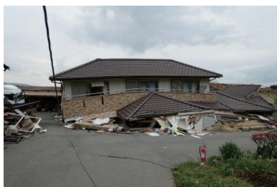
写真 16 倒壊した木造住宅
