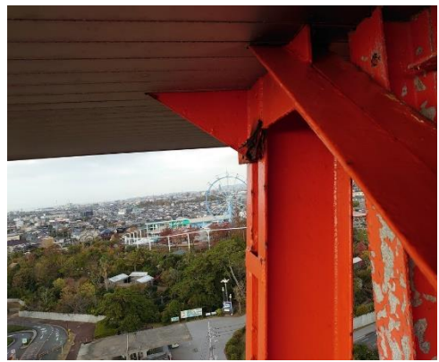
【鉄塔 展望台 下側】 腐食劣化
