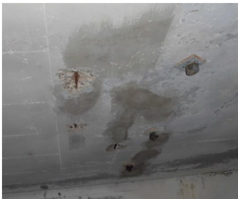
【1階 展示室 天井】 天井コンクリート一部爆裂、鉄筋発錆
