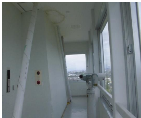
【展望室 天井】 漏水跡(シミ)
