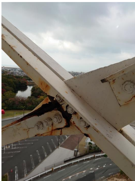
【鉄塔 鉄骨】 腐食劣化
