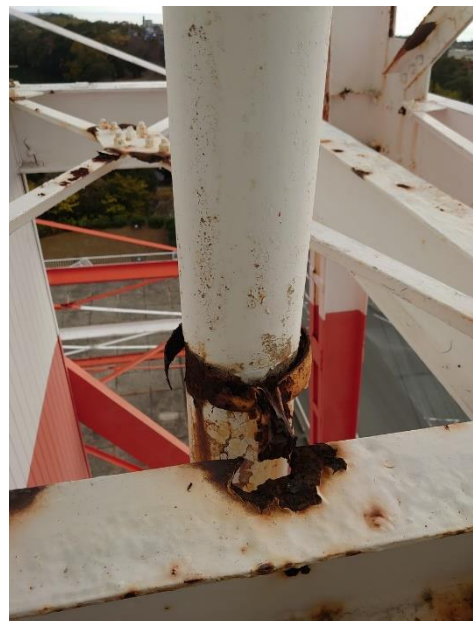
【鉄塔 クランプ】 腐食劣化
