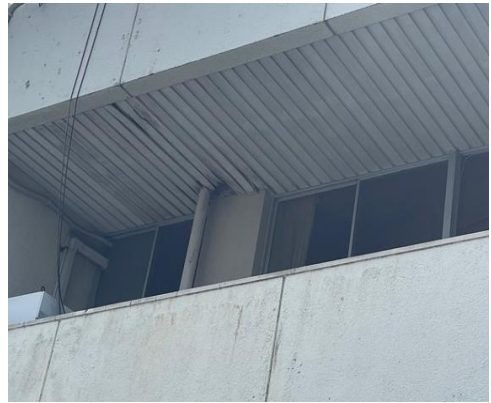
【2階 東側 バランダ 軒裏】 軒天板ズレ、歪み、雨漏り跡
