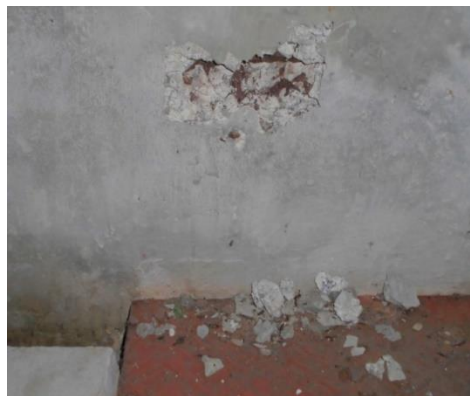
【1階 展示室 内壁②】 壁コンクリート一部爆裂、鉄筋発錆
