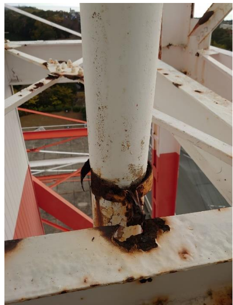
【鉄塔 クランプ】 腐食劣化
