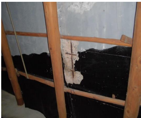
【1階 展示室 内壁①】 壁コンクリート一部爆裂、鉄筋発錆
