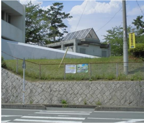
【敷地 南側 フェンス】 全体的に発錆
