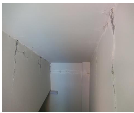
【2階 階段 室内壁】 壁漏水跡(シミ)、塗装剥がれ
