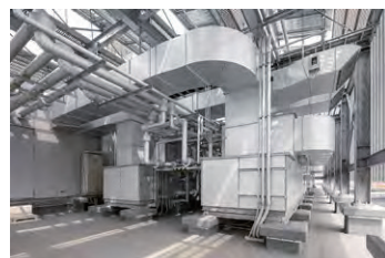
屋上に設置されたデシカント空調機
