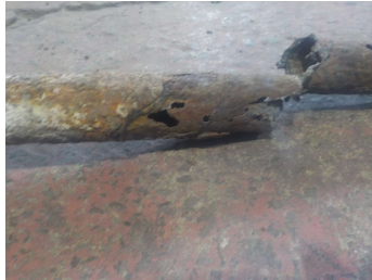
散水設備用配管 破損部
