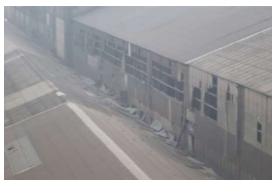
建屋スレート 北壁破損
