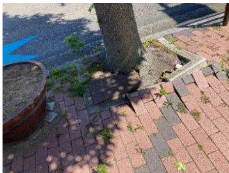
根上がり・舗装クラック
