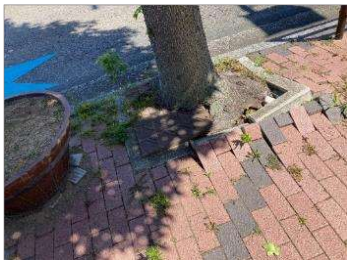
根上がり・舗装クラック
