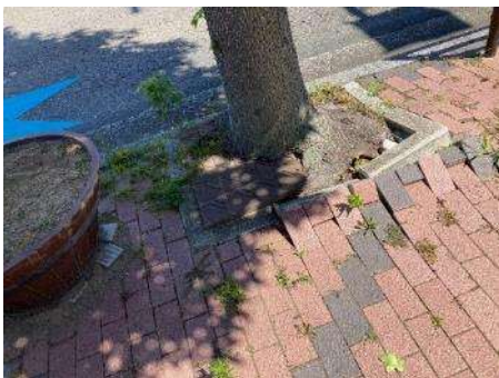
根上がり・舗装クラック
