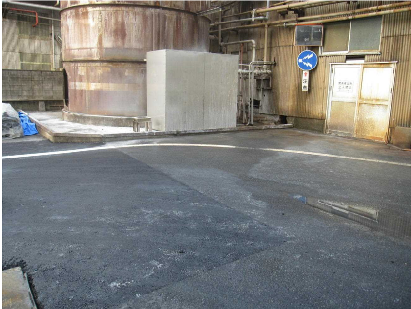
清掃後の路面
