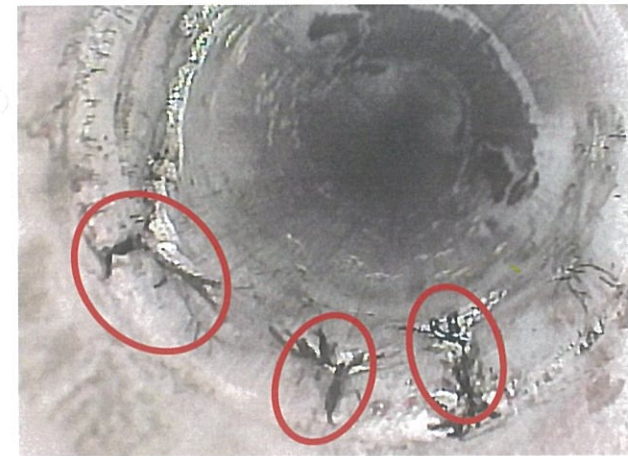
管内部に10mm程度の亀裂
