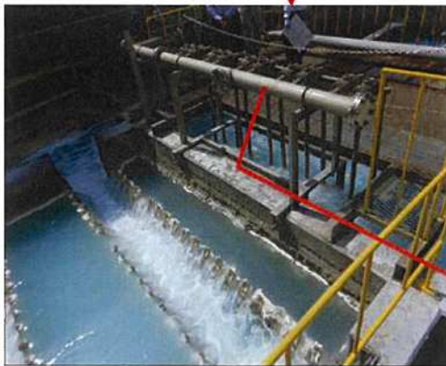
【写真3】曝気槽②(炭酸ガスによる中和)
