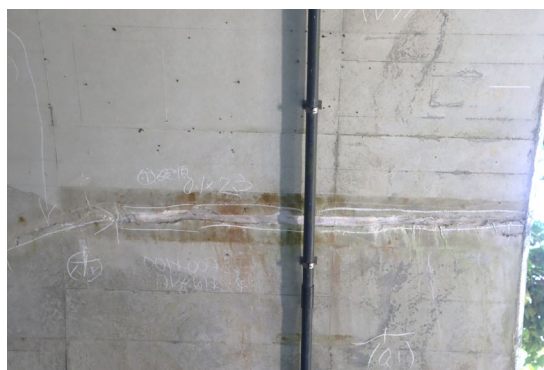
覆工コンクリートのうき・はく離
