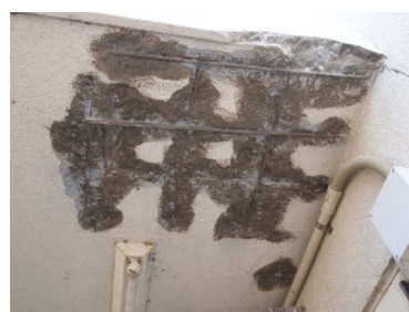
RC 躯体の爆裂
