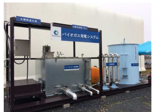
【バイオガス発電モデルプラント】
