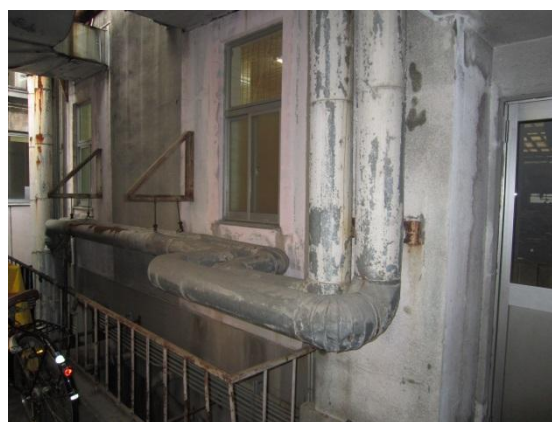
【 本館 配管設備 】
