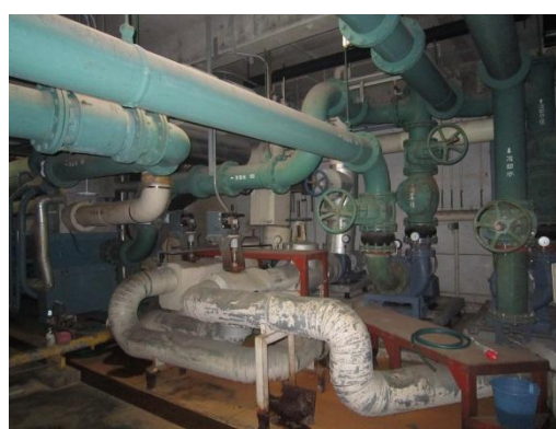
【 本館地下 空調設備 】
