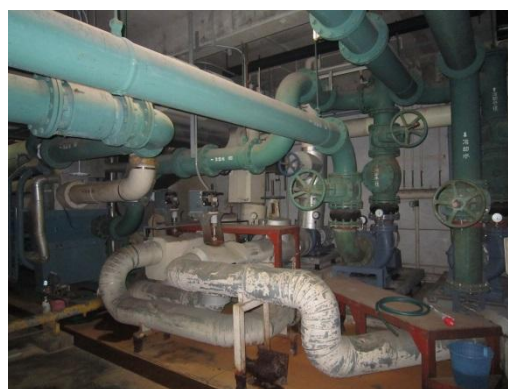
【 本館地下 空調設備 】
