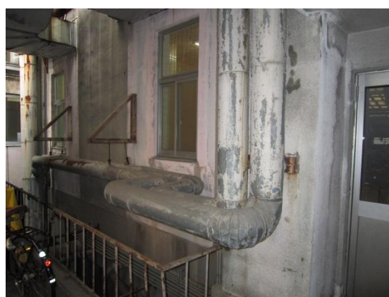
【 本館 配管設備 】
