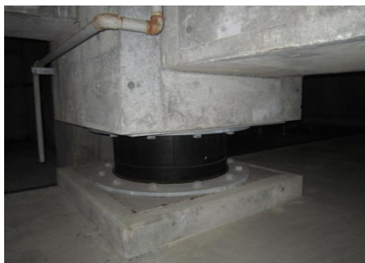
免震装置(地下)
