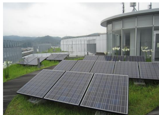
太陽光パネル(屋上)
