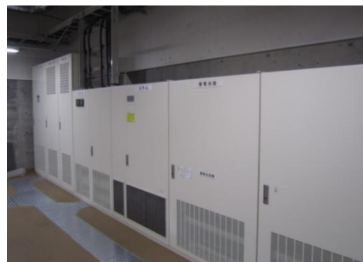
非常用電源(地下)
