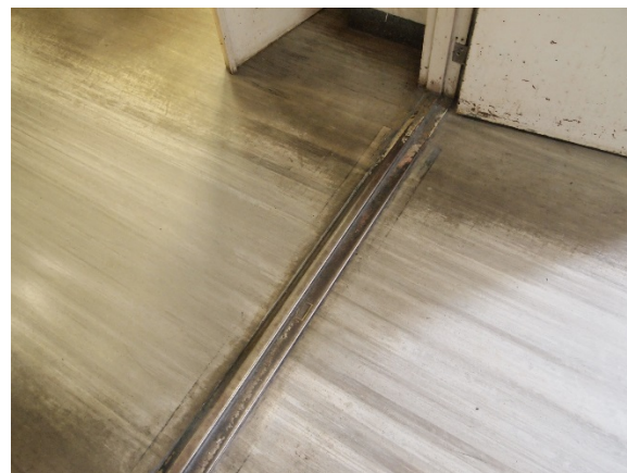
廊下に見られる段差
