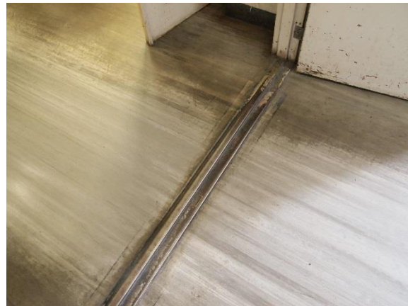
廊下に見られる段差
