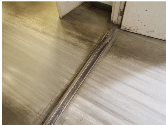
廊下に見られる段差
