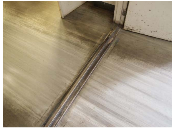
廊下に見られる段差
