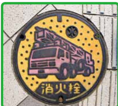
しょうかせん ① 消火栓
