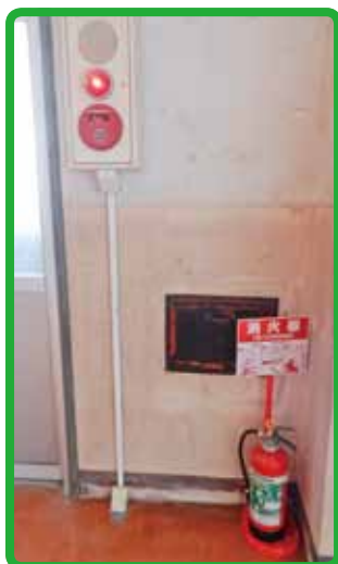
① 火災報知機と消火器
