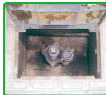
しょうかせん ① 消火栓の内部
