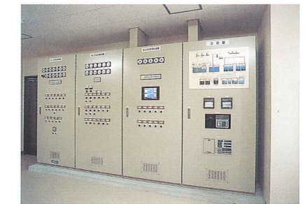
③動力制御盤・計装盤
