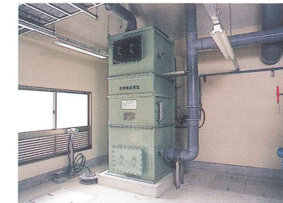
⑤生物脱臭装置
