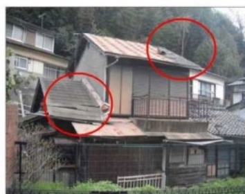
アスファルト屋根等の一部にズレがあり、雨漏りのある例
