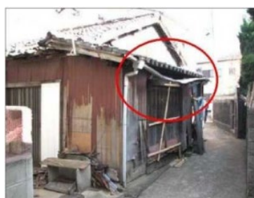
雨樋が破損している例
