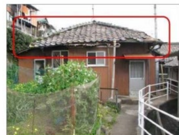
屋根に不陸がある例
